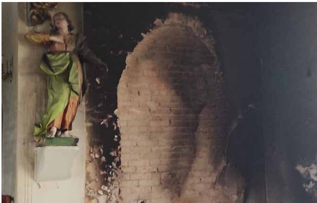
Wnętrze kościoła jest mocno okopcone, spłonęła część ołtarza wraz z obrazem
